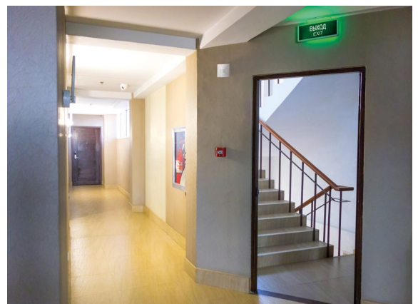
Лестница: аварийные светильники ДПА, датчики движения
