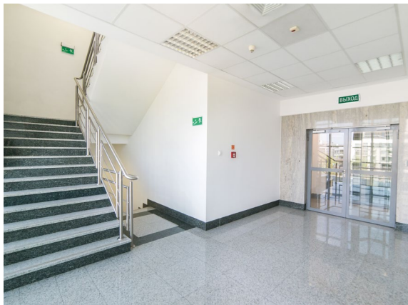
Лестница: аварийные светильники ДПА, светильники ДСП с датчиком движения
