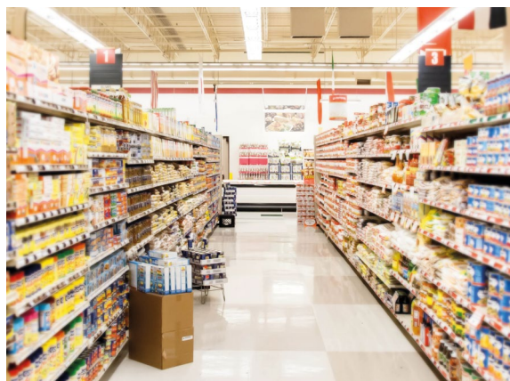
Торговый зал: линейные светильники, светильники ДСП
