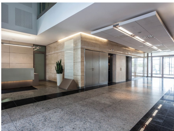
Холл: эвакуационные указатели ССА, линейные светильники ДБО
